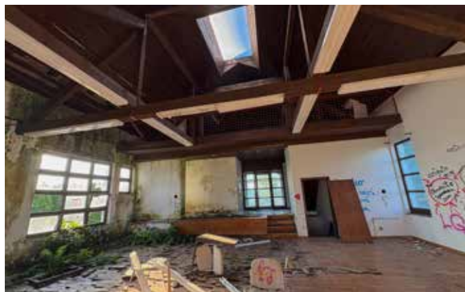
Spomen-dom Orešje opasan je za obilazak i molimo mještane da ne ulaze u zgradu
